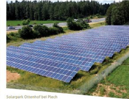
Solarpark Ottenhof bei Plech
