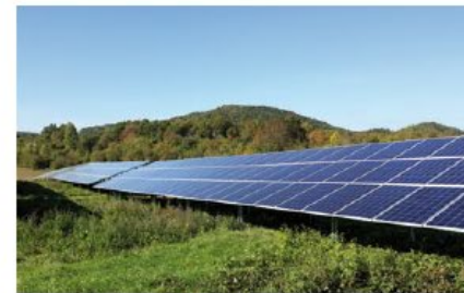
Solarpark Neukirchen bei Sulzbach-Rosenberg
